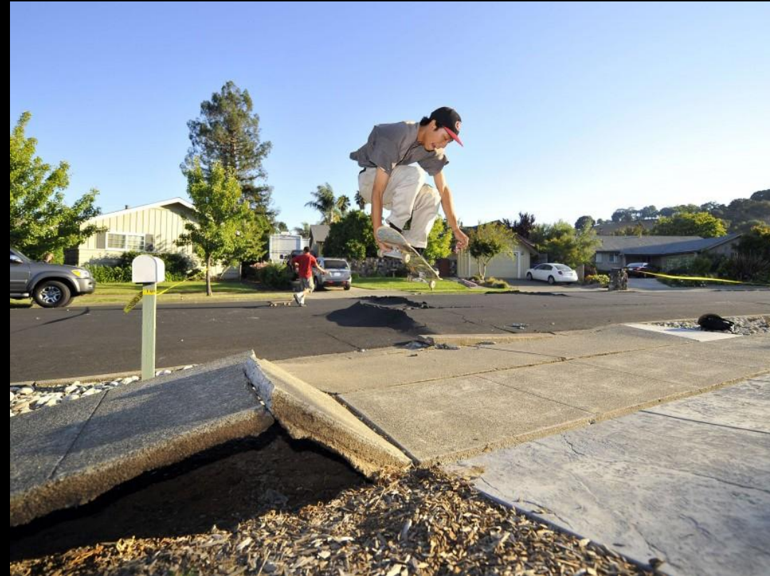
Foto scattata dopo 12 ore dalla scossa
